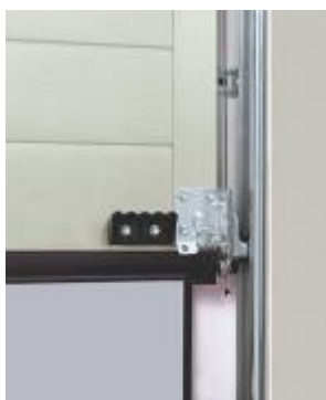
Billede 4: Billedet viser en korrekt wireføring. Stålwirene på denne Hörmann-port er ført mellem portbladet og karmen. Her er både børn og voksne beskyttet mod at komme til skade eller hænge fast.
